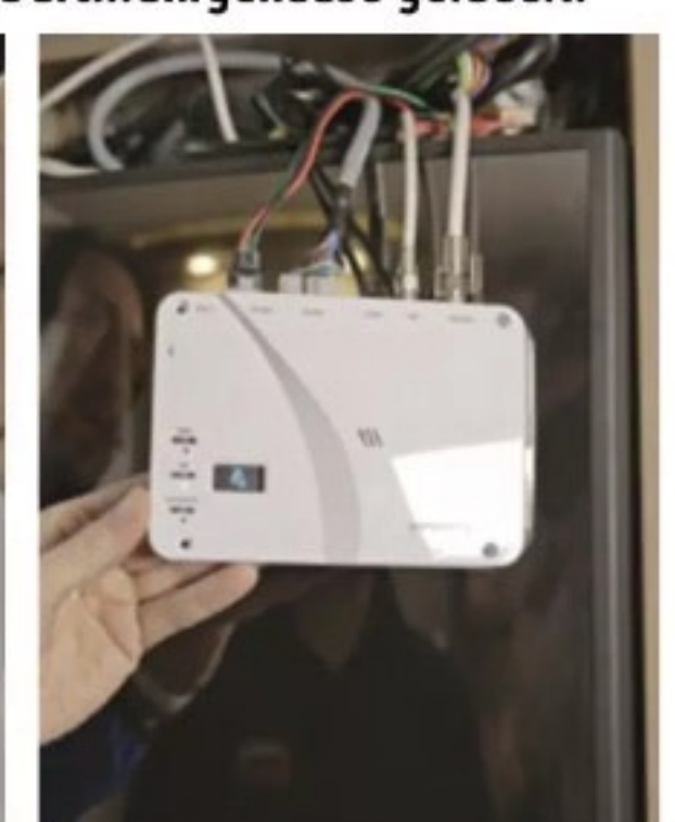
9 Zum Schluss wird innen das Steuergerät verkabelt.
