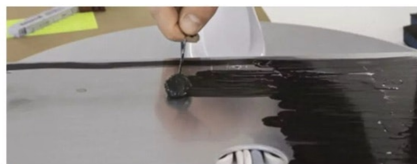
1 Zunächst werden die Klebeflächen auf dem Dach und an der Sat-Anlage vorbereitet. Dazu dient ein sogenannter Primer, der beim Metallfuß ...
